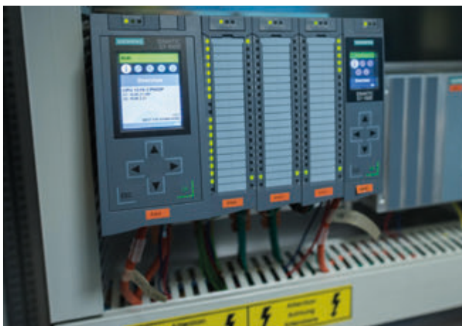
Den lokalen Controllern ist jeweils ein zentraler Controller mit CPU als Anlagensteuerung übergeordnet.
